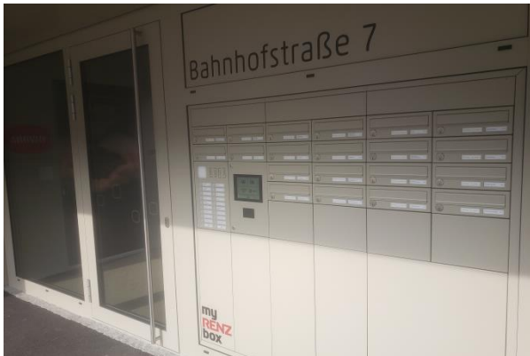
Eingangsbereich mit elektronischer Paketbox
