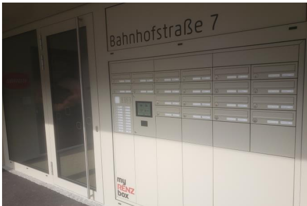
Eingangsbereich mit elektronischer Paketbox
